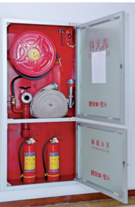
图7-10 建筑物内的消防设施
