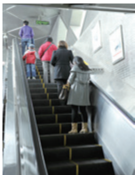
甲 运行中的自动扶梯
