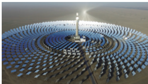
图4.3-5 塔式太阳能电站
