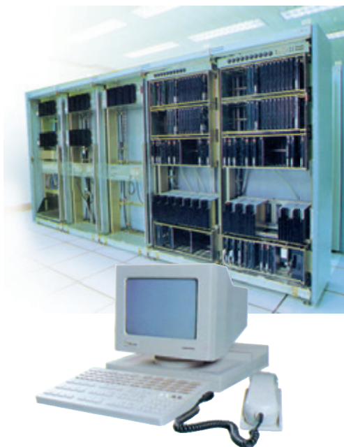
图 21.1-6 程控电话交换机和操作台
