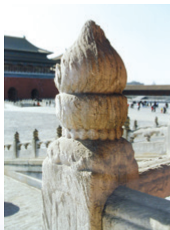
图22.4-3 被酸雨严重腐蚀的汉白玉石柱
